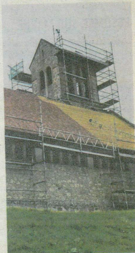
La toiture fortement endommagée.
